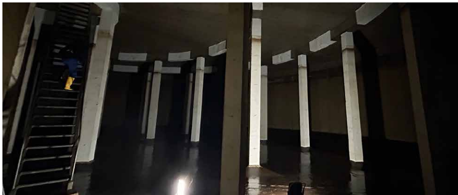
Blick in den Trinkwasser-Hochbehälter Arnstedter Warte
