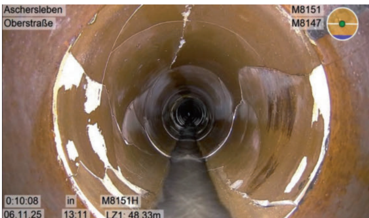
Rissbildungen im Steinzeugrohr
